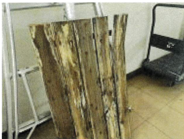
シャワースタールのすのこ破損
