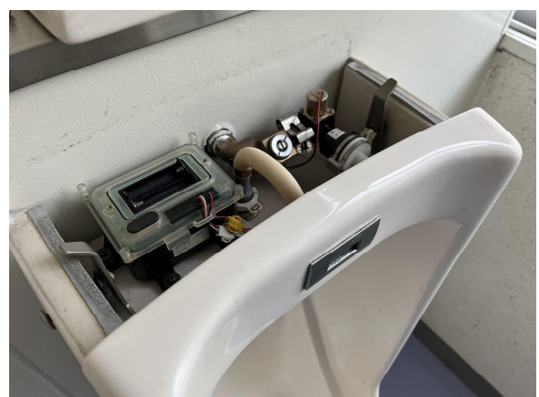
5日 小便器電池交換
