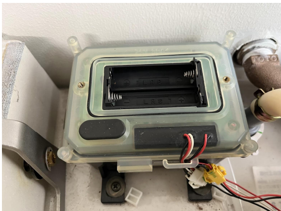
5日 小便器電池交換
