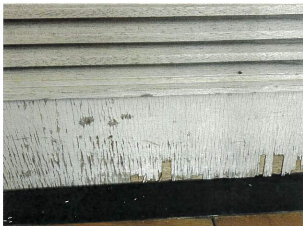
格技場のトイレドア
