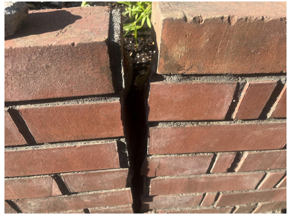
12日 割れてすごい状況
