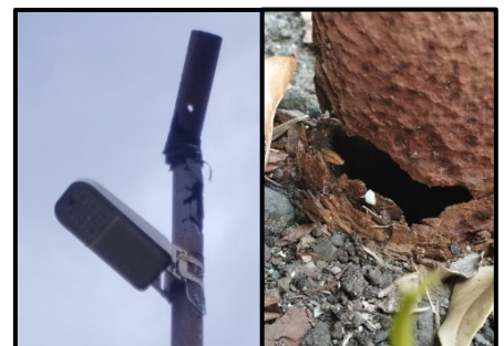
ポールの劣化事例
